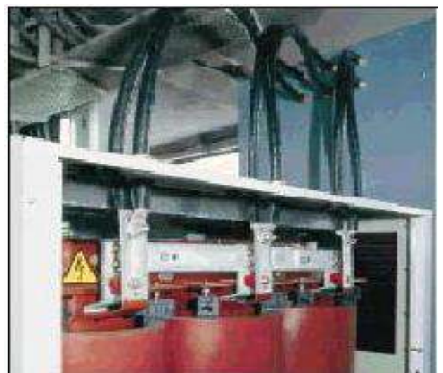
Hình 4–Nối LV bằng PBT và vỏ bảo vệ Figure 4–LV connections with PBT and enclosure
