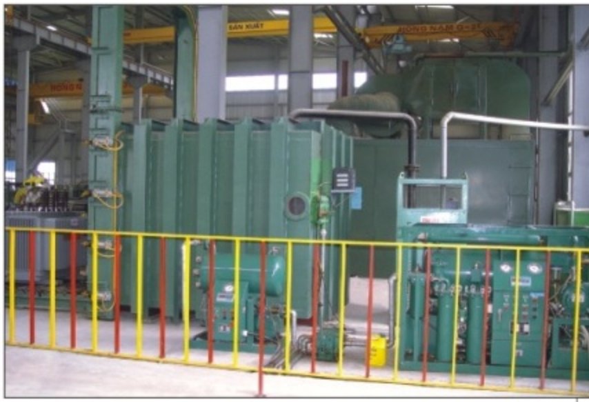
Hệ thống lọc dầu Oil filter system
