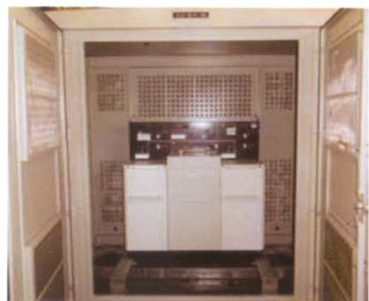
Thiết bị đóng cắt và bảo vệ
