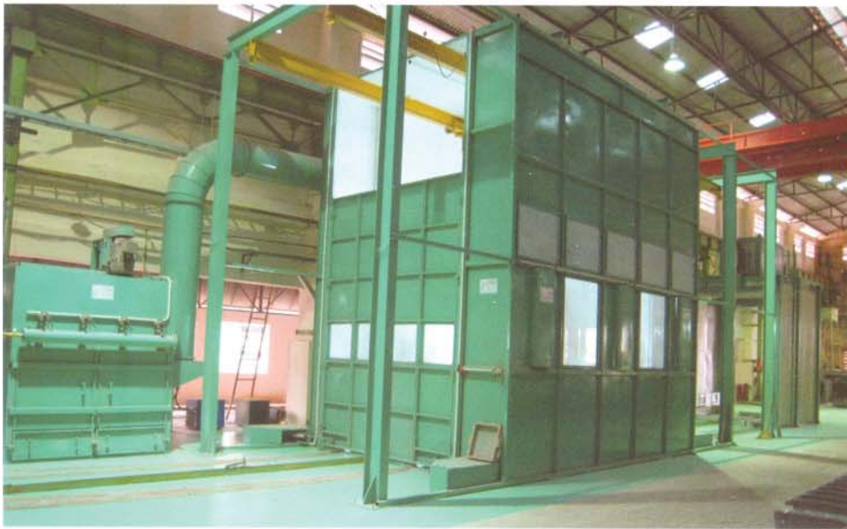
Hệ thống sơn tĩnh điện
