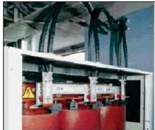
Hình 4–Nối LV bằng PBT và vỏ bảo vệ Figure 4–LV connections with PBT and enclosure
